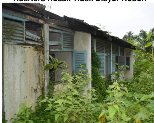
Gambar 3.10 Kuarters Rosak Tidak Disyor Roboh
