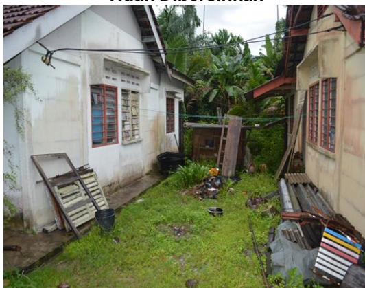
Gambar 3.14 Kawasan Kuarters Berpenghuni Tidak Dibersihkan
