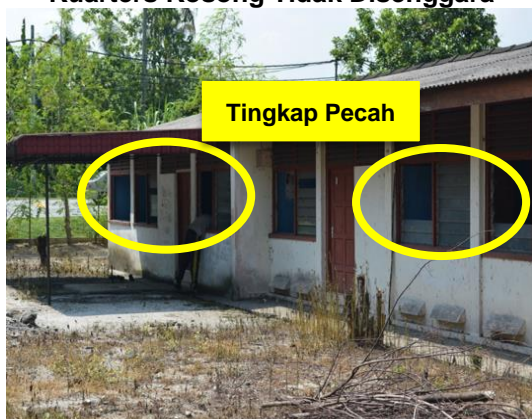
Gambar 3.7 Kuarters Kosong Tidak Disenggara
