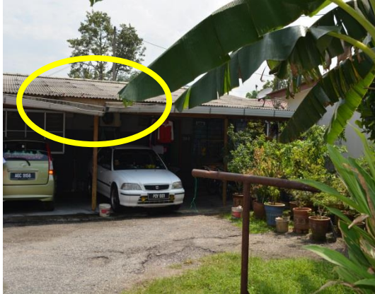
Gambar 3.1 Saluran Air Hujan Rosak
